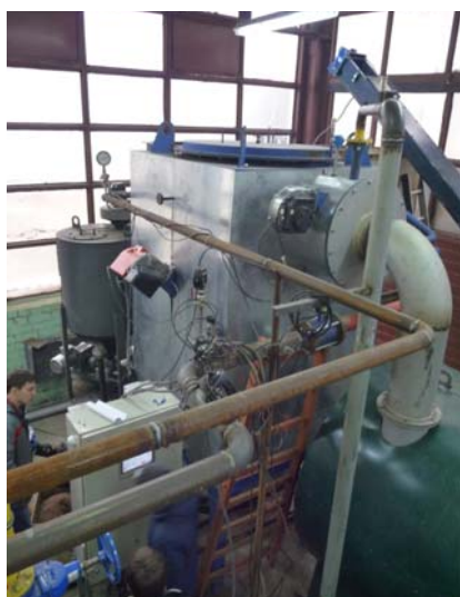
Рис. 1. Внешний вид котла КС-5
