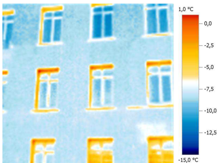
Рис. 3. Фотофиксация и термограмма бокового фасада пристройки к Главному корпусу
